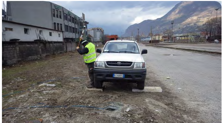
Energizzazione Onde S
