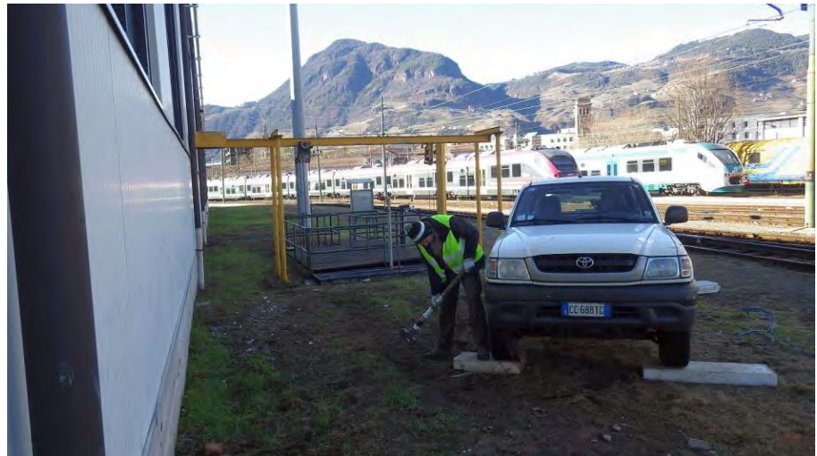
Energizzazione Onde S
